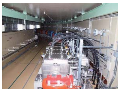
3GeVシンクロトロントンネル内の加速器装置、目視確認では重篤な破損は見受けられず。（3/23）ビームダクトの真空度検査中。
