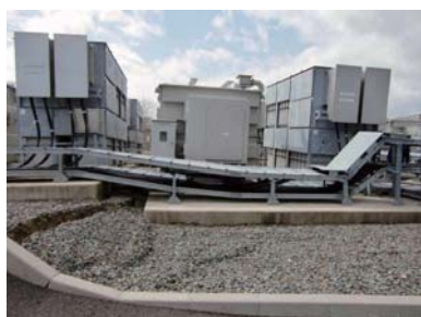
3GeVシンクロトロンの屋外電源設備ヤード。沈下により受電設備やコンデンサなどが傾斜。
