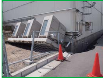
ニュートリノターゲットステーション棟。空調屋外機が地盤沈下で傾斜。
