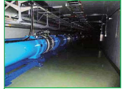
ニュートリノ陽子ビーム輸送ラインの超伝導電磁石。トンネル内に目立った漏水は無し。
