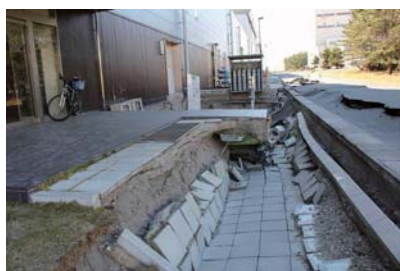
リニアック玄関前。建屋周囲の広い範囲で約1.5mの陥没。配線や配管の一部が破断。
