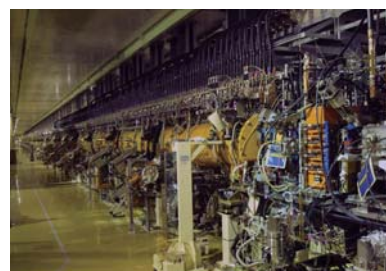
リニアックは加速管転倒などの大きな被害はなし。仮設電源によりトンネル内の排水を3/25以降随時実施。仮設の除湿器を持ち込み、除湿開始。（4/11）
