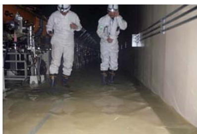
リニアックトンネル内。コンクリートひび割れ部から地下水の漏れ。停電が続き、懐中電灯で浸水状況など確認。（3/24）
