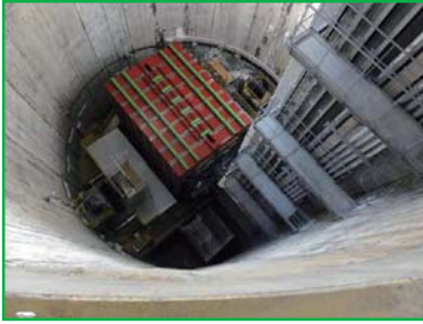
ニュートリノ前置検出器ピット内は、目立った被害は見受けられない。ピット最下階に5cm程度水がたまったが、排水。
