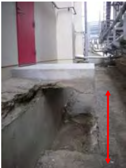
← 実験ホール 入り口の陥没。 1m以上の段差。
