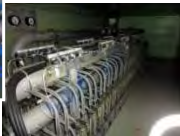
← スイッチヤード 機器は健全。 換気により 湿度も低下。
