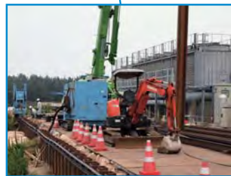
3GeVシンクロトロン棟周回道路外側に、補強のため矢板を打設
