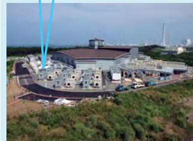
3GeV シンクロトロン周回道路の復旧。電源ヤード、冷却水設備の修復が本格化。
