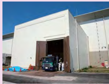
MLF 西側増設建屋は約 15 cm沈下、復旧工事では現在ジャッキアップのための基礎工事を実施。
