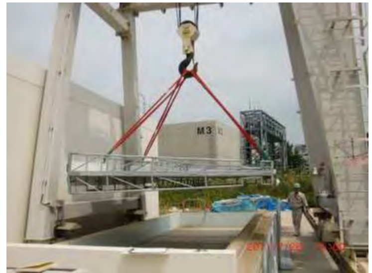
搬入口クレーン
