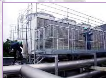
リニアック装置冷却系屋外冷却塔、高圧水による洗浄作業を実施。
