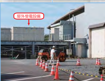
傾いた3GeVシンクロトロン屋外受電設備をジャッキアップにより復旧、8月30日より受電再開。
