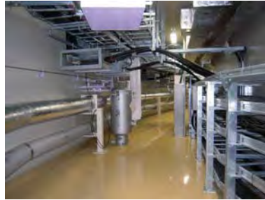
3GeVシンクロトロンは、停電による空調停止期間中に、トンネル内の電磁石ケーブル表面にカビが発生したため、清掃作業を実施。
