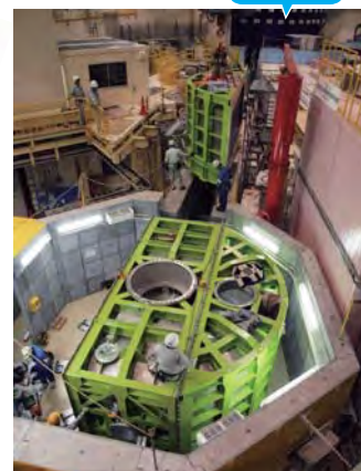
3分割で製作されたBLO2「DNA」の散乱真空槽が搬入・据付られた。
