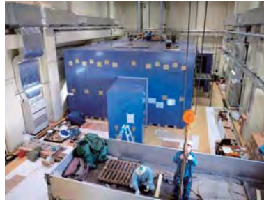
MLFで建設中の中性子BL09「SPICA」装置本体室の設置工事が行われた(東側増設建屋内)。
