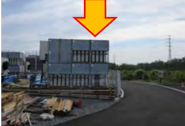
電源ヤード機器の基礎補修や沈下部の嵩上げ作業が完了。
