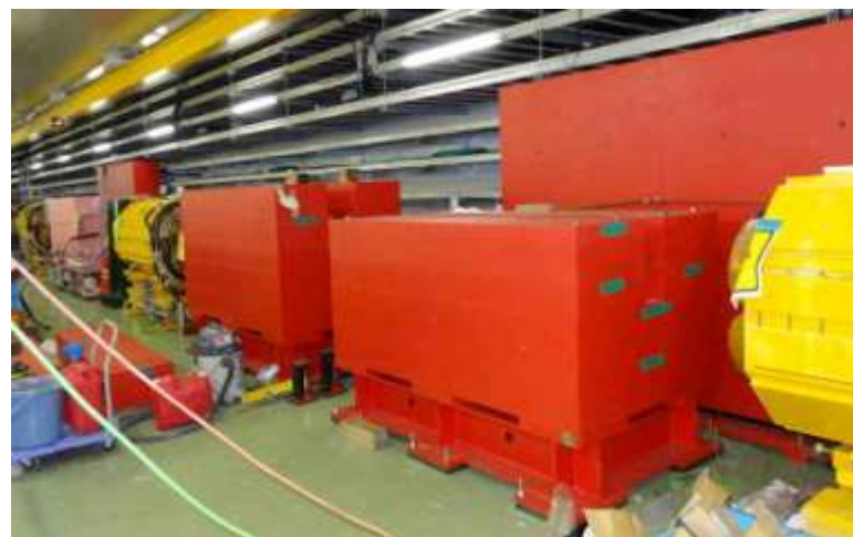
リングコリメータエリアの壁型遮蔽体と、新たに設置したアブソーバー
