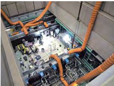
ニュートリノターゲットステーションでは、電磁ホーンの点検、アライメント作業を実施。
