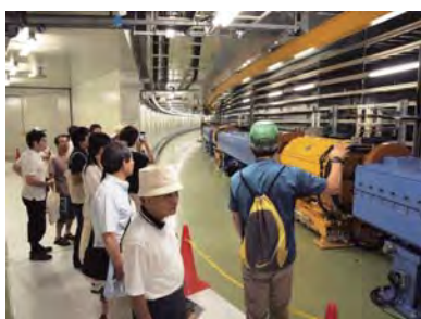
長さ1,600mのトンネルに並ぶ電磁石などを見学(50GeVシンクロトロン)
