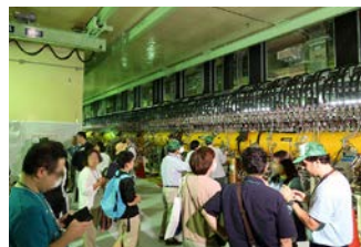
リニアック加速器施設
