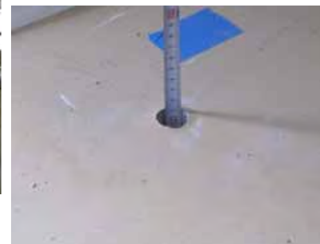
冷却水コールド機械室(1)入口部屋外陥没部近傍:試掘して深さ測定(床下に~50cmの空間がありそう)
