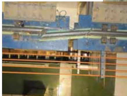
クライストロンギャラリーのクレーンレール(一部脱落)
