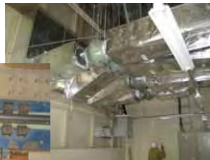
脱落しかかっている空調ダクト
