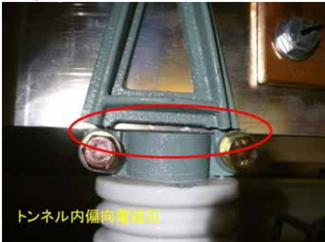
偏向電磁石の一部破損した鋳物
