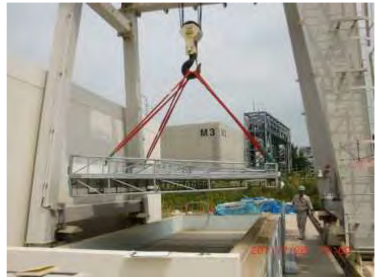
搬入口クレーン
