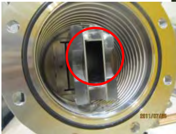
スーパーミラーの破損
