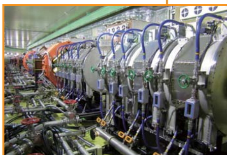
トンネル内に設置の加速空洞
