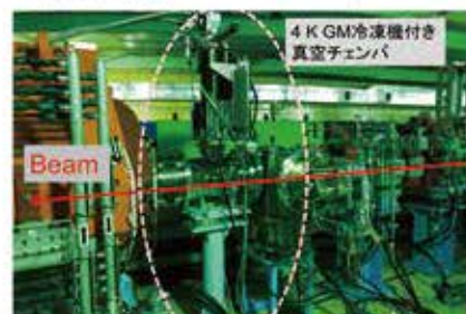
4K GM 超低温冷凍機を RCS ビーム取り出し部直下の 3NBT ビーム輸送ラインに設置
