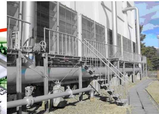
冷却塔周辺の地盤沈下
