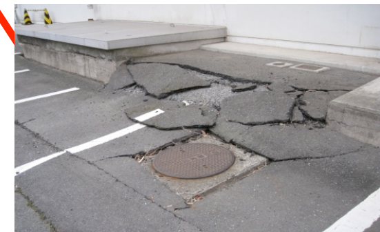
実験利用棟周辺の地盤沈下
