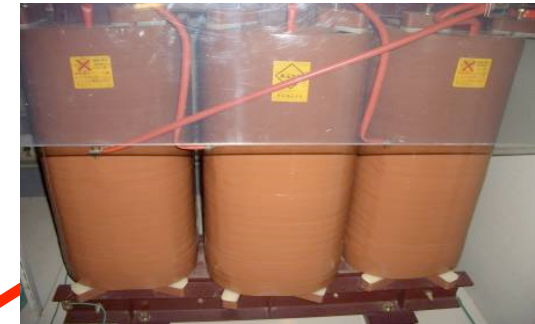
2次冷却塔変圧器の損傷
