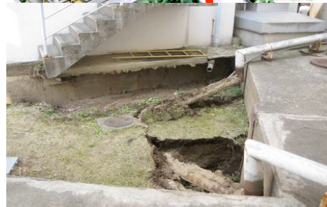
燃料管理施設周辺の地盤沈下
