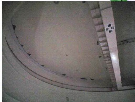
原子炉建家天井の破損
