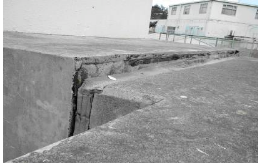
排気塔と共同溝のずれ
